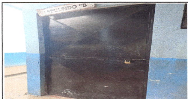
Foto 11: la puerta de segundo B ya cierra y abre correctamente, sin problema que se pueda caer.
